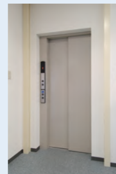
●エレベーター
